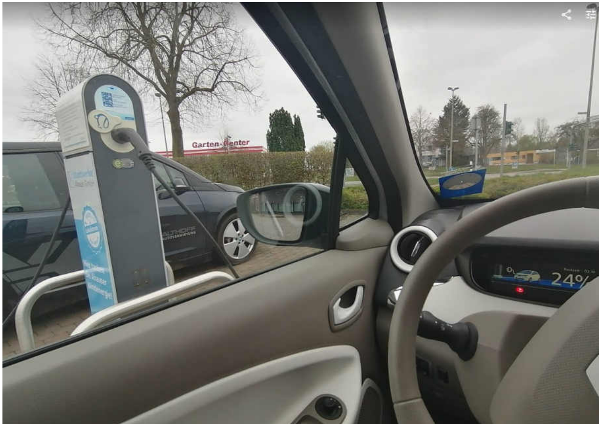
Abbildung 19: Laden an einer öffentlichen Ladesäule mit Wechselstrom (AC) und einer Leistung von bis zu 22 kW
