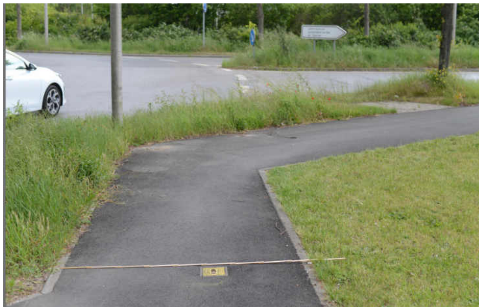
Abbildung 90: Die Breite des Weges ist mit 1,70 m statt 2,50 m unzureichend. Die Trassierung ist nicht der Fahrdynamik eines Fahrrades bei 12-20 km/h angepasst.
