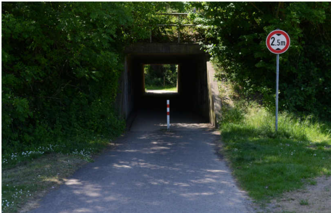
Abbildung 101: Die Unterführung stellt einen Bereich der subjektiven Unsicherheit dar. Die Verkehrssicherheit ist aufgrund der Sichtverhältnisse ebenfalls nicht gewährleistet
