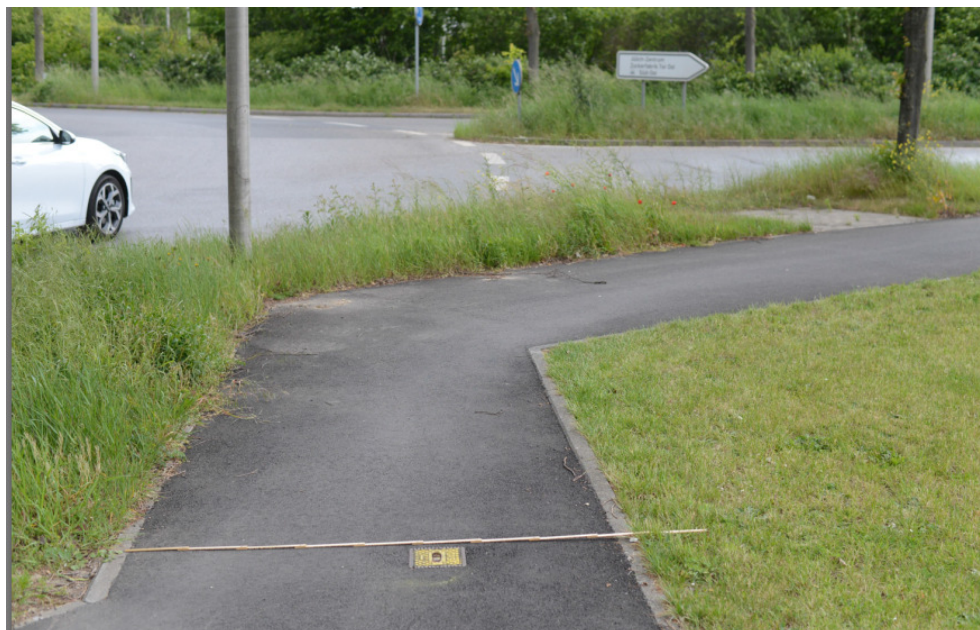
Abbildung 89: Die Breite des Weges ist mit 1,70 m statt 2,50 m unzureichend. Die Trassierung ist nicht der Fahrdynamik eines Fahrrades bei 12-20 km/h angepasst.
