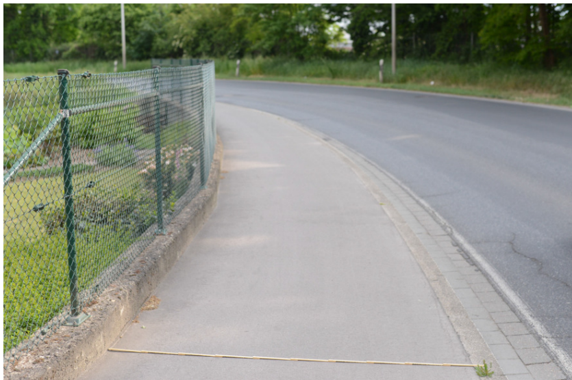
Abbildung 90: Eine Engstelle, die nicht mit vertretbarem Aufwand beseitigt werden kann
