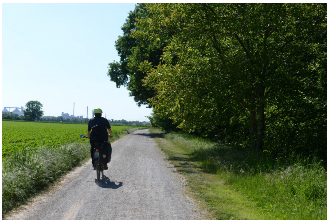
Abbildung 55: Der vorhandene Schotter- und Splitweg ist teils schadhaft und unkomfortabel zu befahren. Staubentwicklung bei Trockenheit, Dreck bei Nässe dämpfen das Fahrerlebnis
